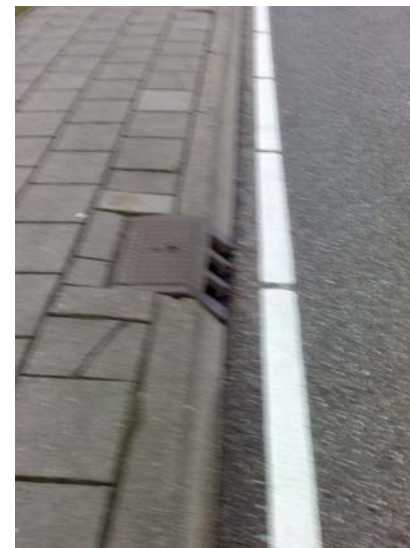
Imbornal colocado en bordillo montable.
