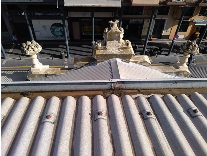
Uniones deficientes en los empalmes
