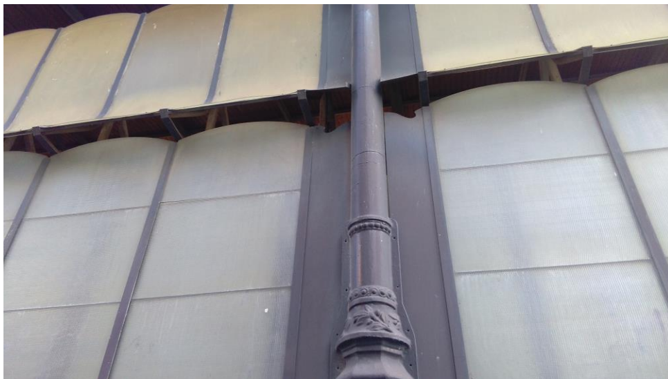
Pilar fracturado. Nº15 Lado Oeste
