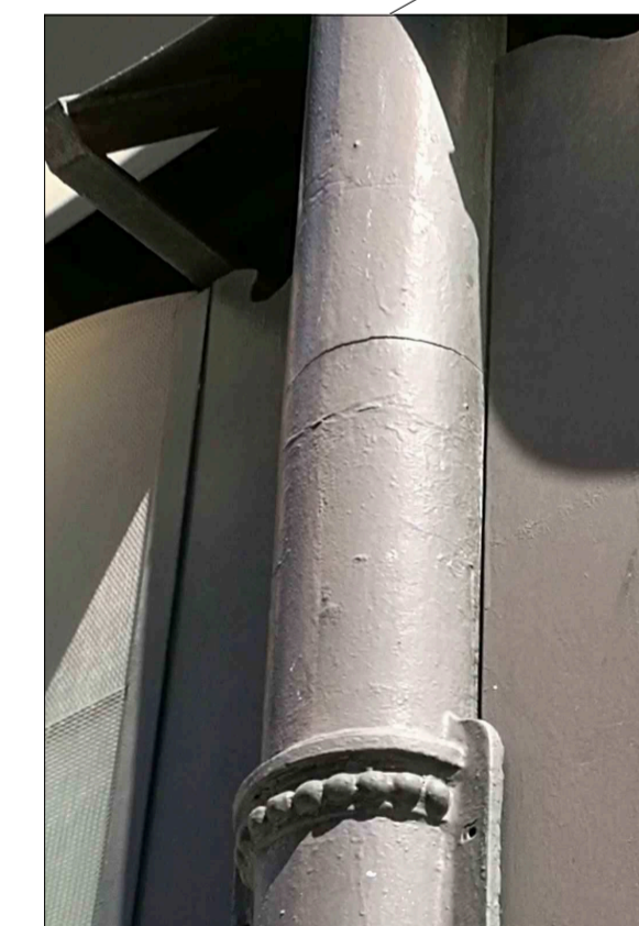
F3: Pilar 15 (fisurado)
