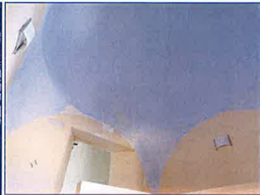
Detalle de patologías en cúpula escalera
