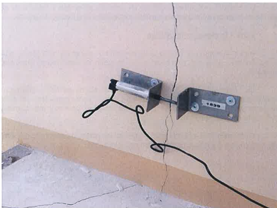
Fotografía de fisurometro potenciométrico instalado.
