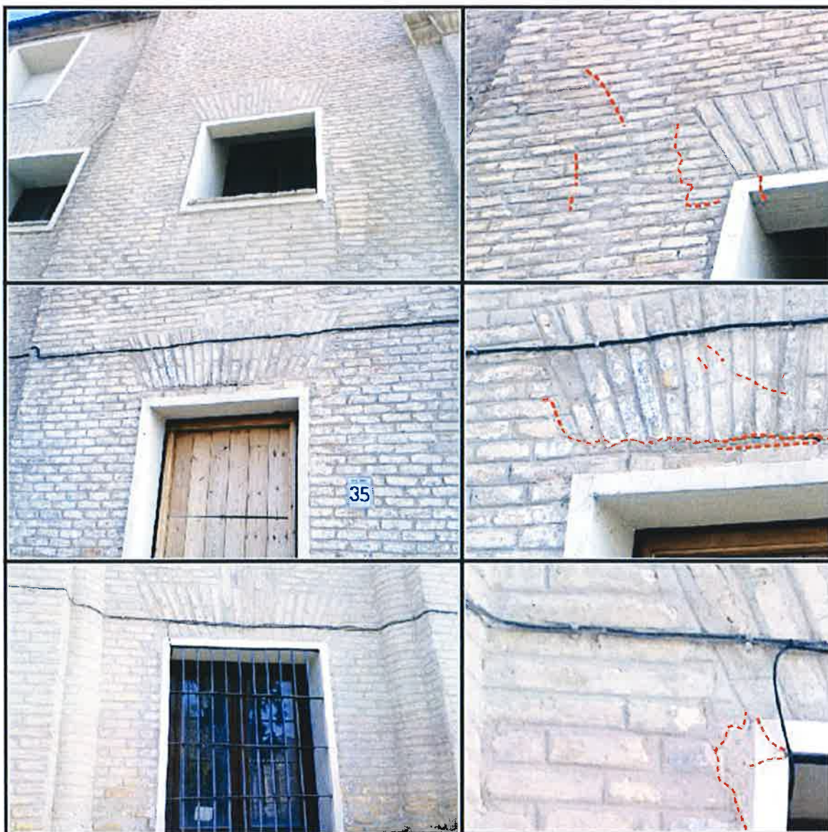
Figura 2. Grietas y patologías afectando a la fachada de la Portería en la calle San Bruno.
