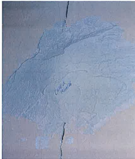
Fotografía de testigo de yeso en seguimiento
