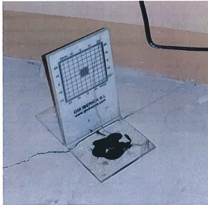
Fotografía de fisurometro analógico instalado
