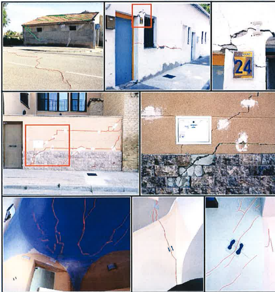
Figura 3. Grietas y patologías del entorno e interior de la Portería.
