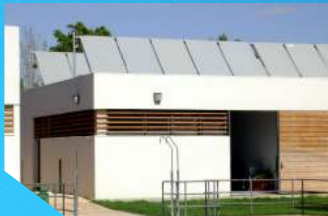
Se observa en la imagen la instalación de placas solares para calentar el agua en un centro comunitario (CDM San Gregorio)
