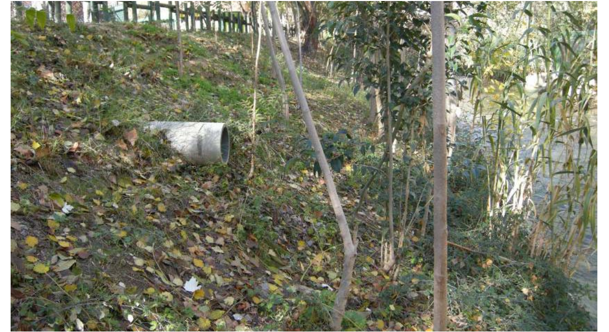
A continuación desaparecen los gaviones y los taludes no tienen ningún tratamiento y la vegetación es muy escasa
