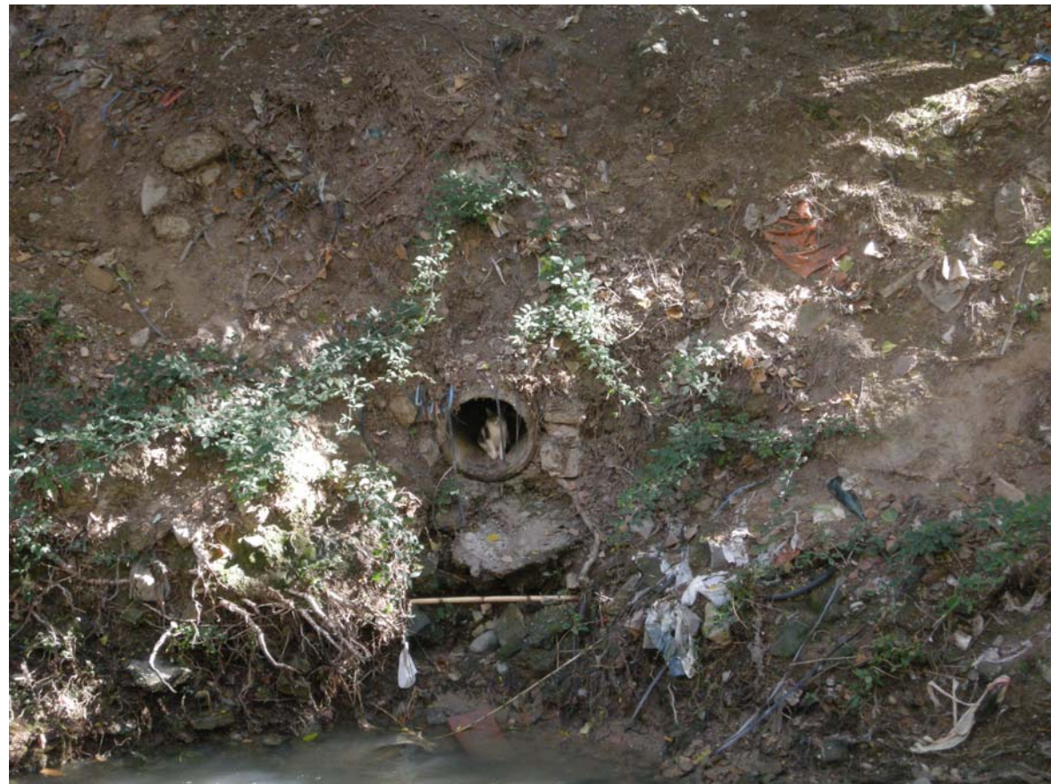
Gato en una salida de saneamiento de la calle Porvenir. Obsérvese la calidad del talud. Todo escombros.
