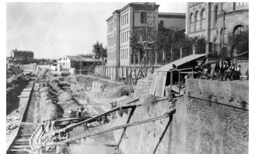
Obras de cubrición del Huerva en Gran Vía, junto a la Facultad de Medicina en 1924. (Fuente: Carlos Blázquez)
