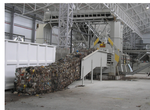
Líneas de recuperación de papel y metal dentro del Centro de tratamiento de residuos
