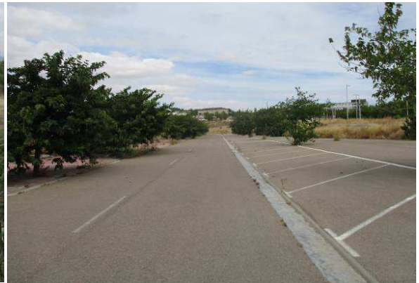
Fig.29: Calles sin uso y sin salida rodeadas de solares vacíos en el Campus Universitario.
